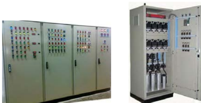
شکل ۵-۱۳ تابلو توزیع برق صنعتی
