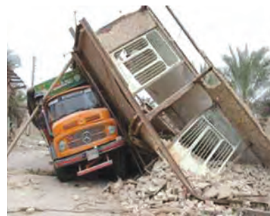
الف) ریزش دیوار در اثر زلزله
