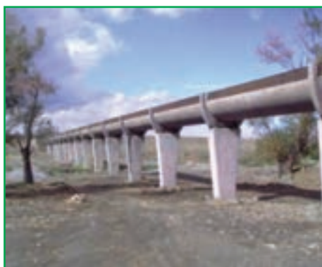
شکل ۱-۴۵- کانال انتقال آب (سیاه کمر)
