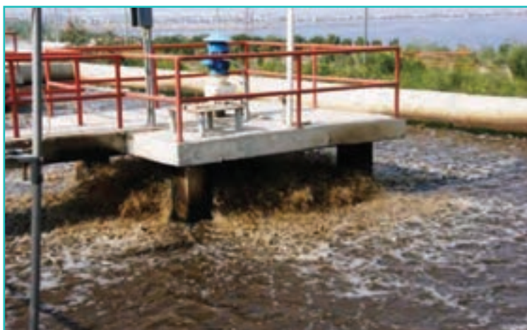
شکل ۵-۶- تصفیه‌خانه فاضلاب ارومیه
