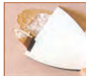
الف - باز کردن ترک‌ها
