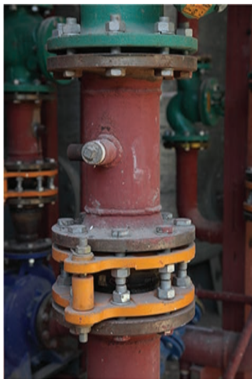
شکل ۲۰- ارتعاش گیر روی پمپ
