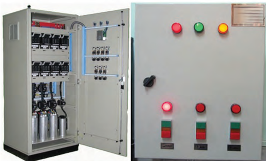
شکل ۴- تابلو برق ایستاده
