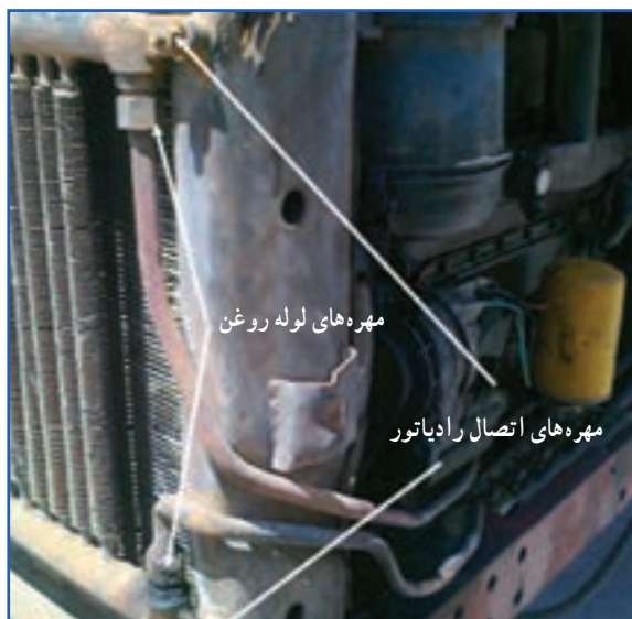
شکل ۳۸-۷- مهره های لوله روغن سمت رادیاتور روغن
