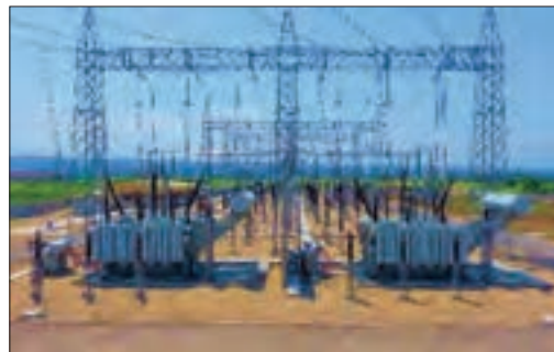
شکل ۳- پست تقویت ولتاژ
