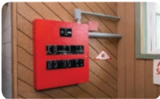
شکل ۳-۴۹- تصویر تابلو کنترل
