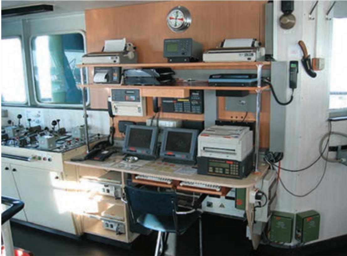
شکل ۸- تجهیزات GMDSS در کشتی
