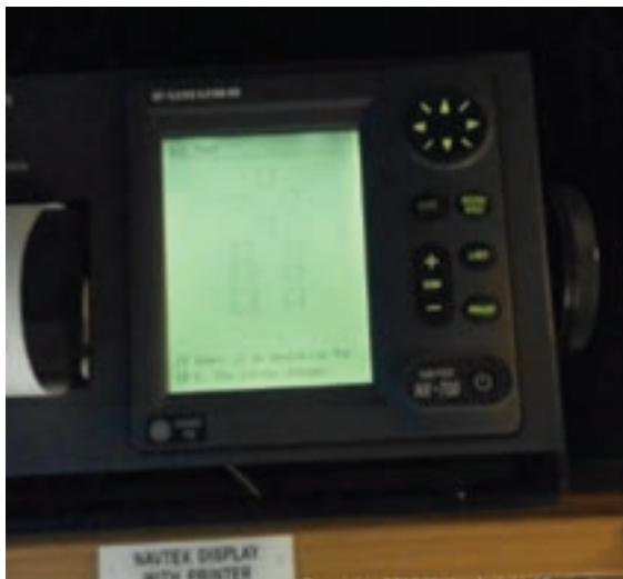
شکل ۴۳- آزمایش کلیدهای دستگاه NAVTEX
