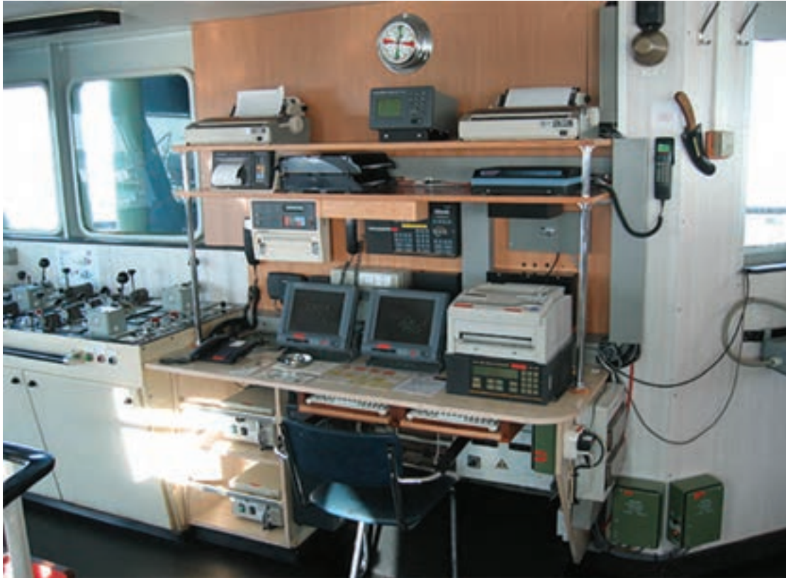
شکل ۸- تجهیزات GMDSS در کشتی
