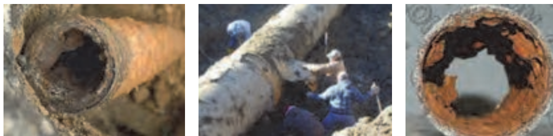
شکل ۴- نمونه‌ای از خوردگی لوله‌های دفن شده
