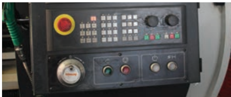
شکل ۱۶- قسمت اپراتوری سیستم کنترل
