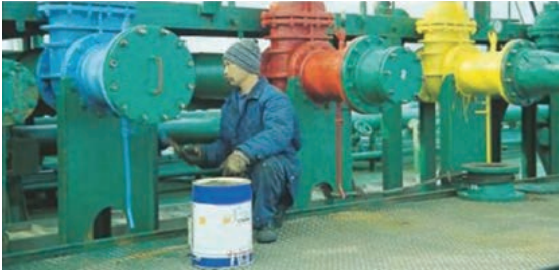
شکل ۵۵- رنگ آمیزی سامانه‌های لوله‌کشی بر روی عرشه
