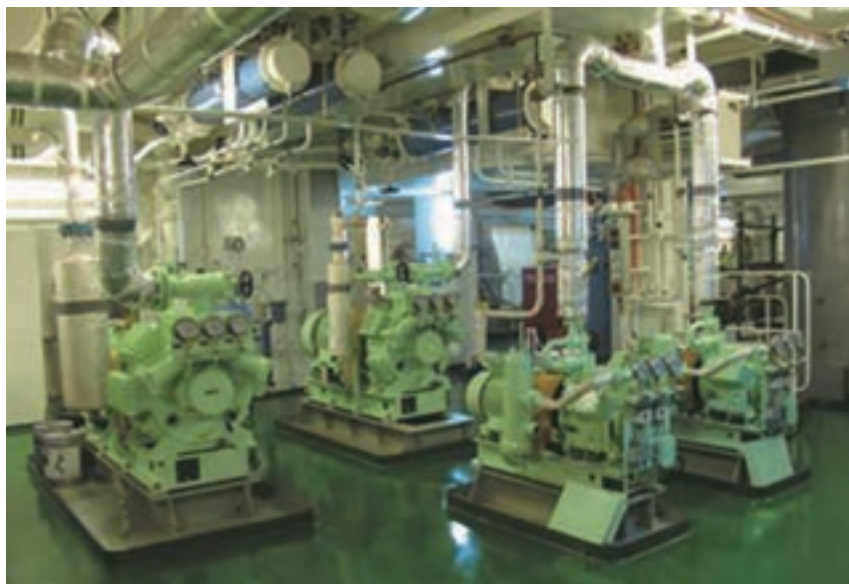
شکل ۱۹- کمپرسورهای هوا در ساختمان کشتی
