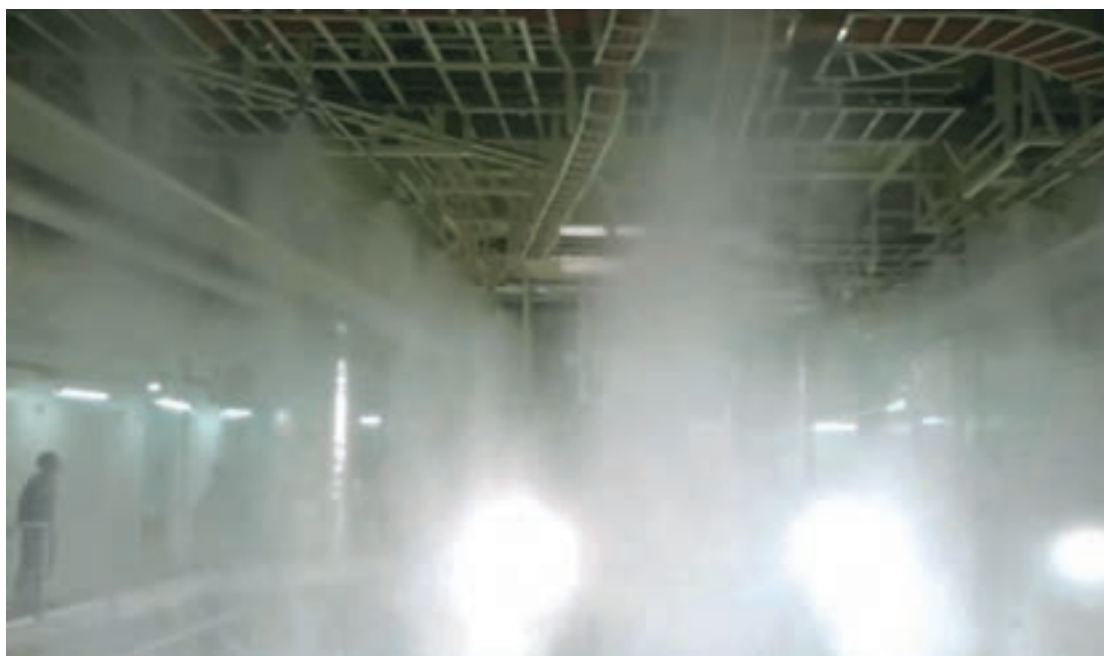
شکل ۱۶- عمل کردن حسگرها در موتورخانه یک کشتی
