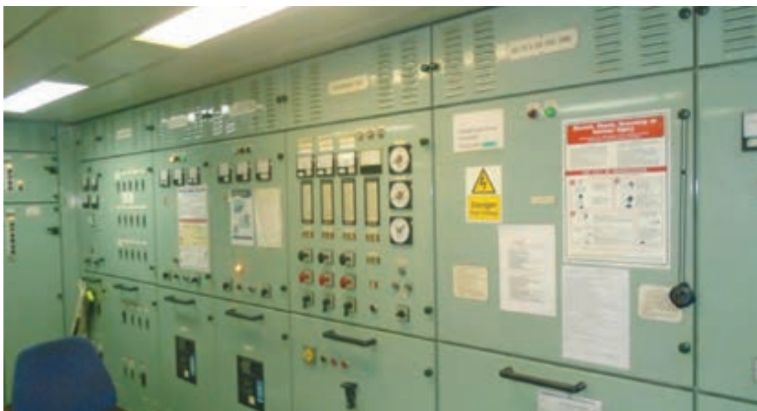
شکل ۲۳- تابلوی اصلی برق شناور
