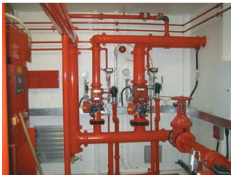
شکل ۱۰- قسمتی از سامانه آتش نشانی یک شناور
