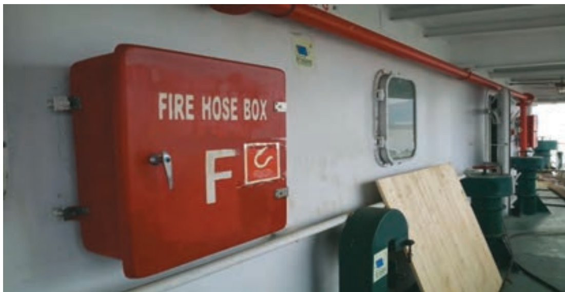
شکل ۱۱- قسمتی از سامانه آتش نشانی بر روی عرشه یک کشتی
