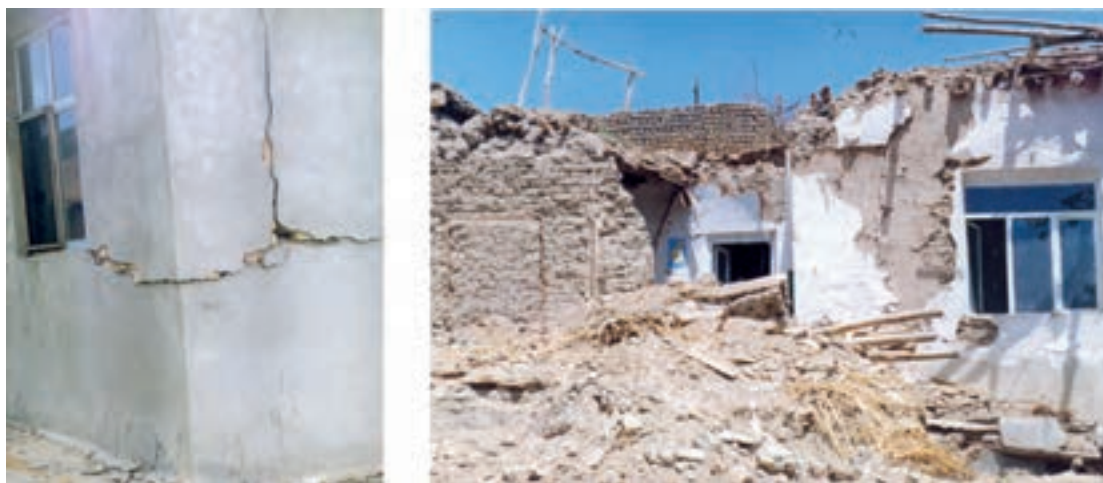
شکل ۳۶-۱- تصاویری از خسارت زلزله اردیبهشت ۱۳۸۱ در دینور
